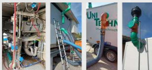
Fotoreihe Anschluss der mobilen Abluftbe- handlungsanlage an die Zentrifuge
