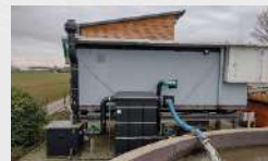
Neu errichtete stationäre Abluftbehandlungsanlage für die Schlammmentwässerung
