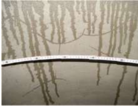
Risse nach Befeuchten
